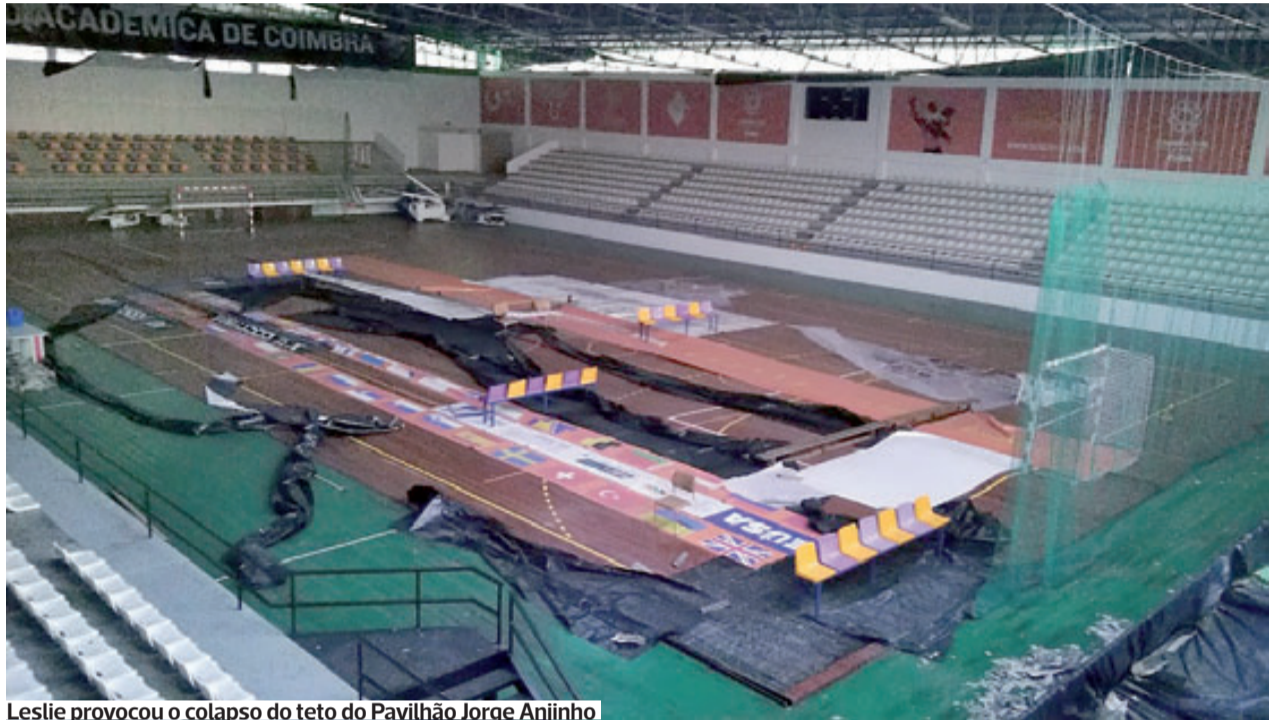
Leslie provocou o colapso do teto do Pavilhão Jorge Anjinho
